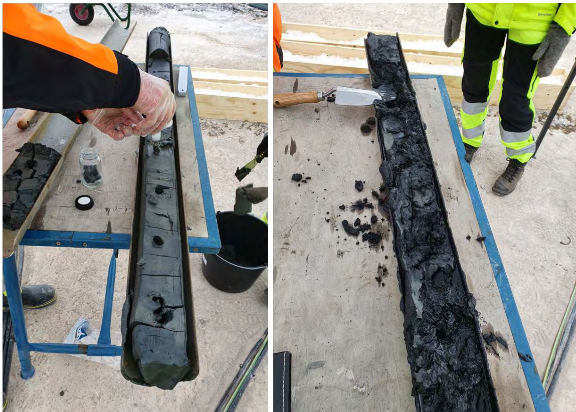
Figur 13 Till vänster: Provtagning av borrhärlor med terracore provtagare vid provpunkt 21SA10 innehållande acceptabla föroreningshalter. Till höger: Borrhärlor vid provpunkt 21SA09 nivå -6(-7,5) m u my, som hade kraftigt förhöjd halt av PAH.
