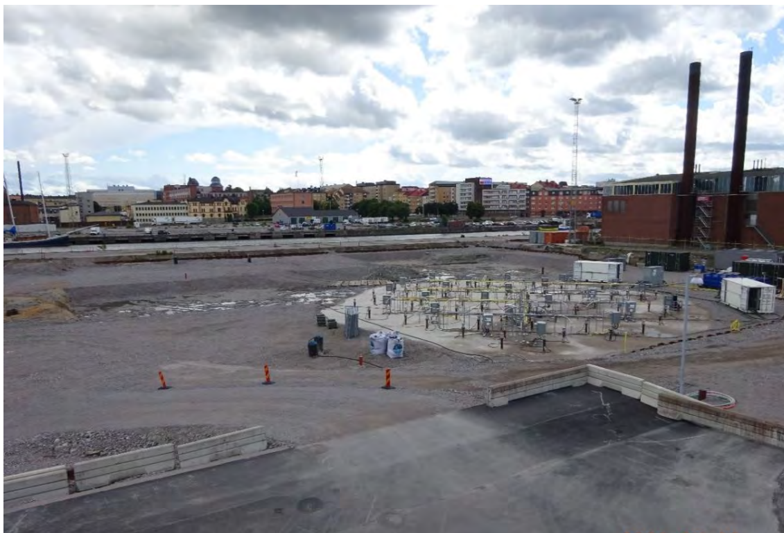
Figur 6 Installation av den termisk termiska behandlingen på plats och redo att driftsättas.
